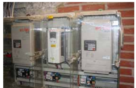
Die Frequenzumrichter im Fundament des Fernrohrs (Foto: Eckehard Rothenberg)
